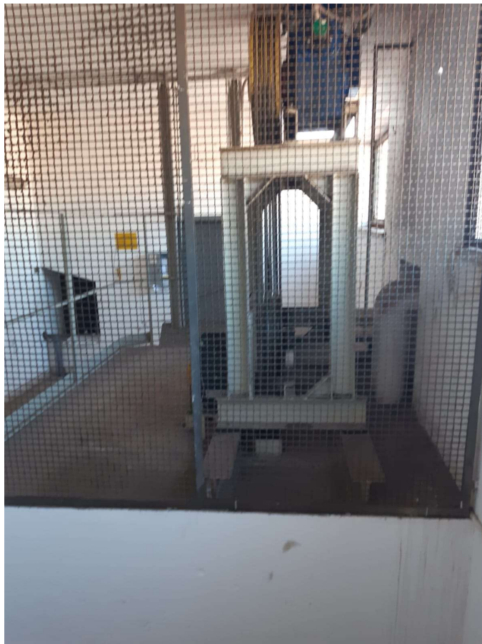
Foto n. 18: locali sotto tetto, vano macchine ascensore
