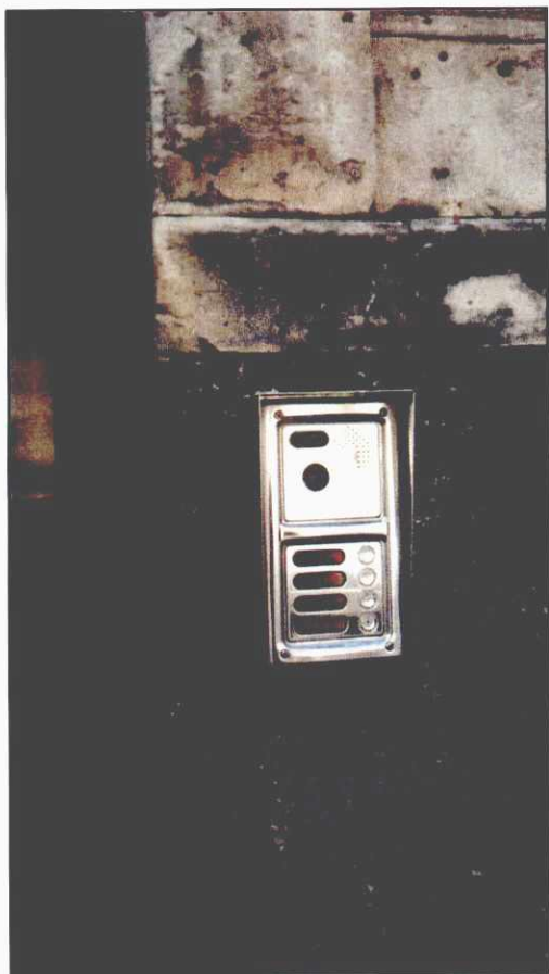
PULSANTIERA VIDEOCITOFONICA Pv01
