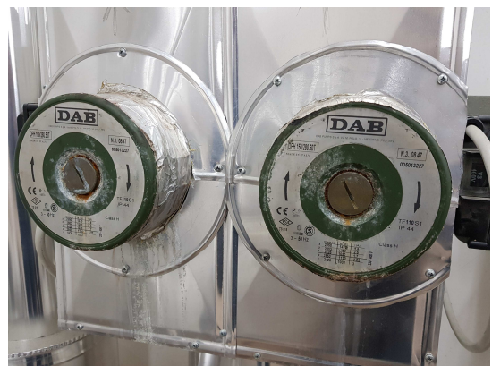
Elettropompe da sostituire
